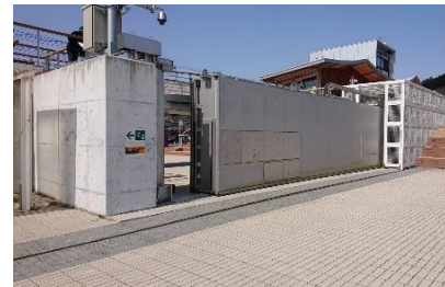
〔内湾に設置されている陸閘〕
